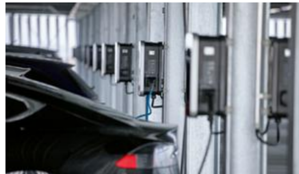
Stromtankstelle im Parkhaus Ditzingen
