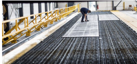
<span style="line-height: 115%; font-family: "Arial", "sans-serif"; font-size: 11pt;">Da der Tisch der Laseranlage ist ebenerdig ist, lassen sich die Bleche gut und einfach einbringen (Bilder: Norbert Voskens).</span>
